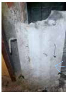
Un danger réel Impact de l'explosion d'une bouteille dans l'un des fours de l'UVE
